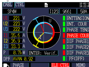
Écran de contrôle du câblage
